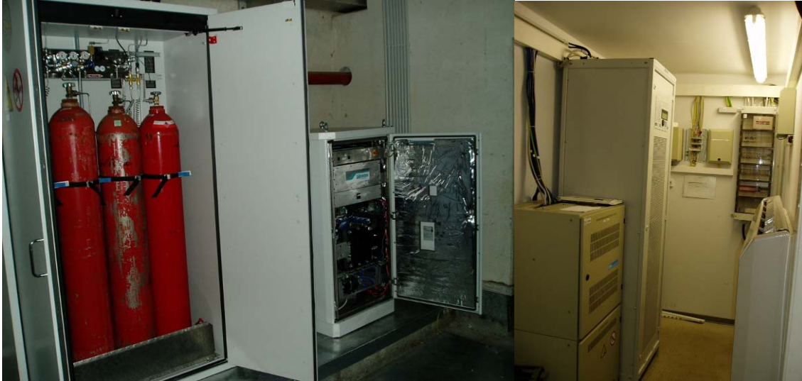
Brennstoffzellen-Anlage im Signal-Iduna-Park Dortmund
